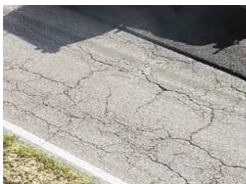
3. Un particolare degli ammaloramenti presenti sulla S.R. 11 prima dell'intervento di manutenzione del 2022
